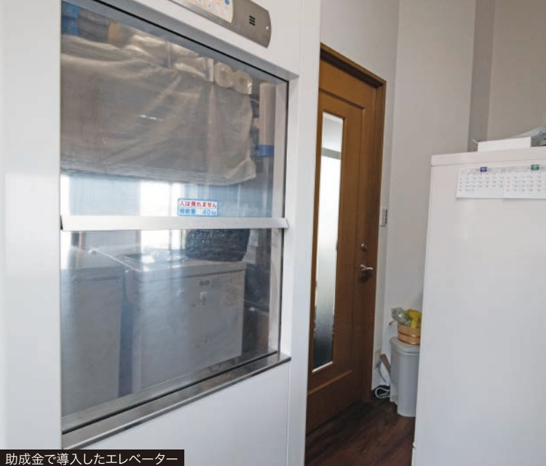
助成金で導入したエレベーター
