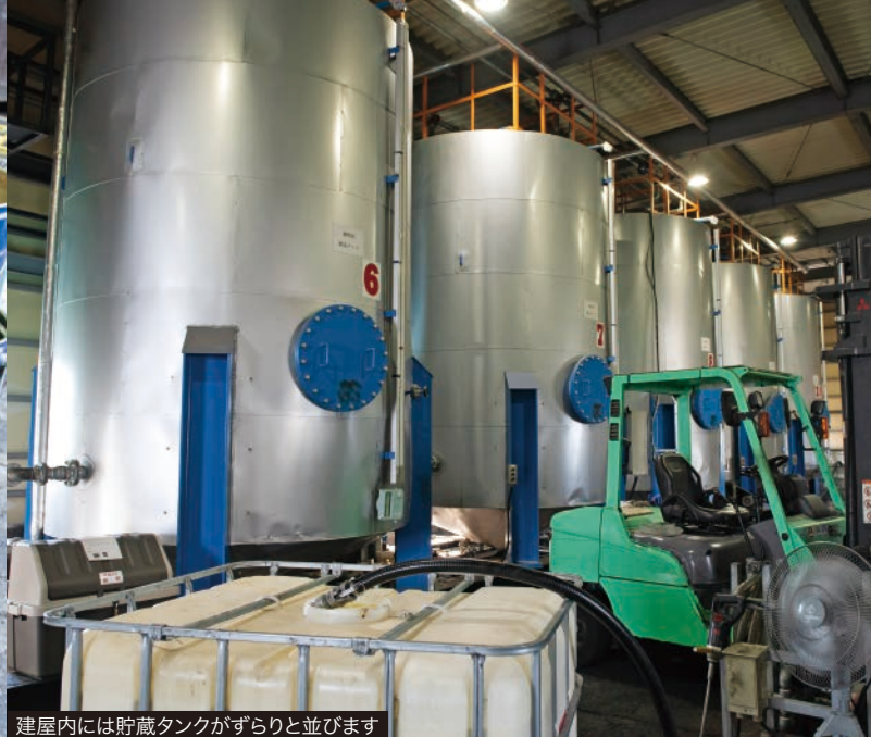
建屋内には貯蔵タンクがずらりと並びます
