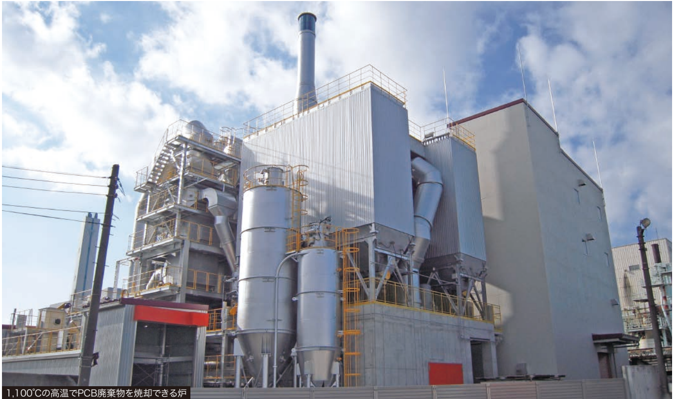
1,100°Cの高温でPCB廃棄物を焼却できる炉
